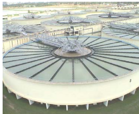
รูปที่ 2 Clarifier ที่ใช้ในโรงผลิตน้ำประปาบางเขน ที่มา : โรงผลิตน้ำประปาบางเขน
