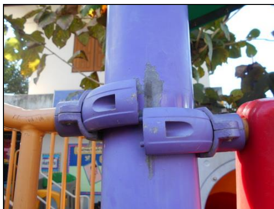
ภาพประกอบ 12 ตัวอย่างระบบล๊อคบริเวณจุดต่อของอุปกรณ์เกิดการชำรุด
