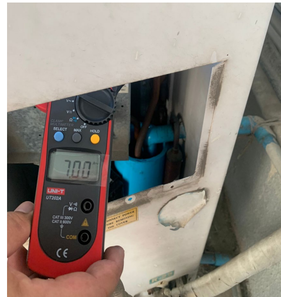
ภาพประกอบ 10 เครื่องปรับอากาศที่ติดตั้งอุปกรณ์ระบายความร้อนจากน้ำทิ้งของพัดลมคอยล์เย็น
