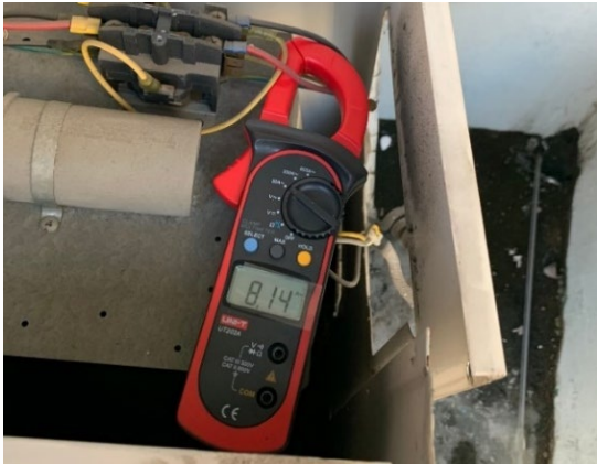
ภาพประกอบ 7 เครื่องปรับอากาศที่ไม่ได้ติดตั้งอุปกรณ์ระบายความร้อนจากน้ำทิ้งของพัดลมคอยล์เย็น
