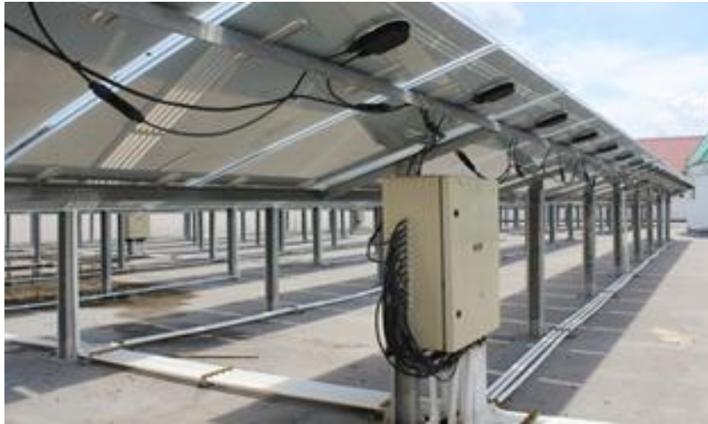
ภาพที่ 3 กล่องรวมสายได้แผงเซลล์แสงอาทิตย์
