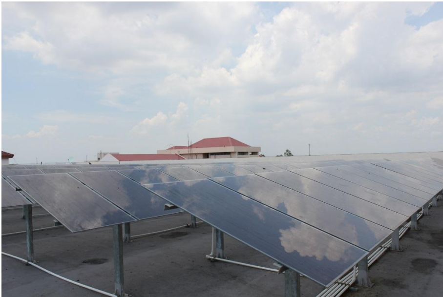
ภาพที่ 2 การติดตั้งระบบผลิตไฟฟ้าด้วยเซลล์แสงอาทิตย์ขนาด 20 กิโลวัตต์บนหลังคาอาคาร
